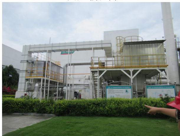
分子筛转轮吸附浓缩+三床式 RTO 燃烧装置
