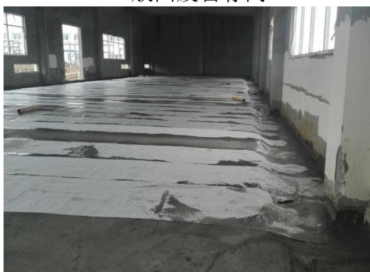
危废间采取防渗漏膜进行防渗
